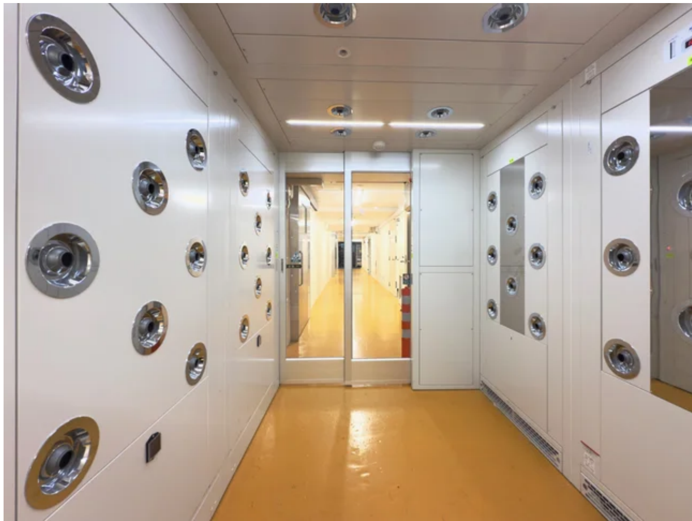
キッチン出入口：エアシャワー
